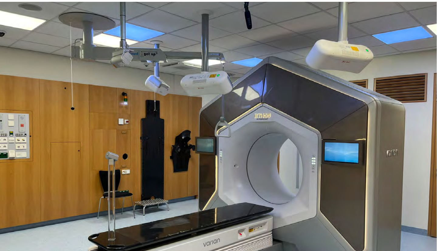
Strahlentherapiebunker am Universitätsklinikum Freiburg: Wegen der an der Decke befestigten Trackingsysteme wurde dort ein teleskopierbares get up installiert. Um eine Kollision zu vermeiden, wird sowohl der Aktionsradius als auch der Teleskopierbereich limitiert und elektronisch gesperrt. Bild: Febromed/UK Freiburg
